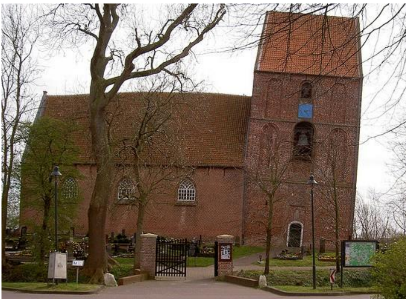
Voorbeeld van een ongelijkmatige verzakking
