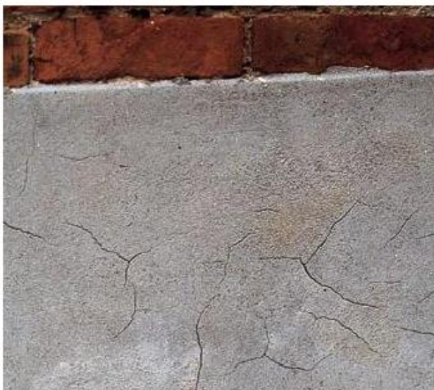
Beton dat krimpscheuren vertoont door verharding.
