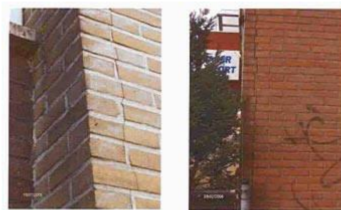
Scheuren die zijn ontstaan op de hoeken van de gevel.
